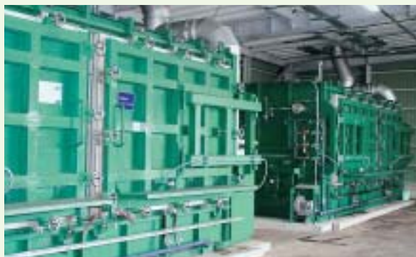
炭化プラント内部
