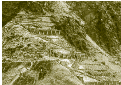
▶ 裸地化した足尾の山 現在柵工等による緑化工事が進められている。
